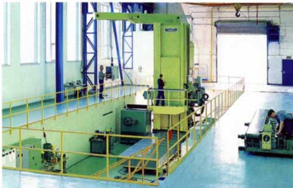
Für die Montage der neuen großen Tragschieber-Bohr- und Fräsmaschine wurde bei Rottler extra eine neue Halle in Betrieb genommen
